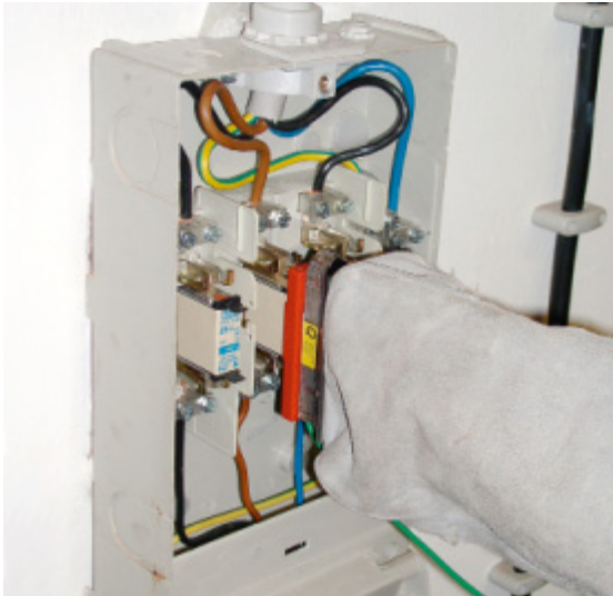
Ziehen eines NH-Sicherungseinsatzes
